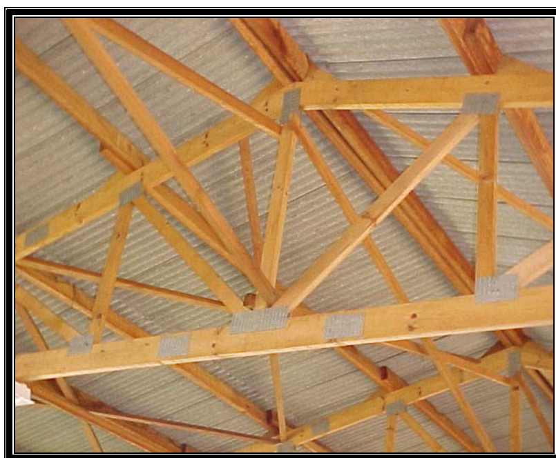
Figura 01 – Estrutura de cobertura executada com CDE's como elemento de união nas ligações
